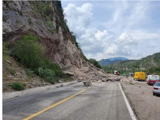
Figura 9. Deslizamiento en carretera Totolapan, Oaxaca. I = VIII ESI-2007.
