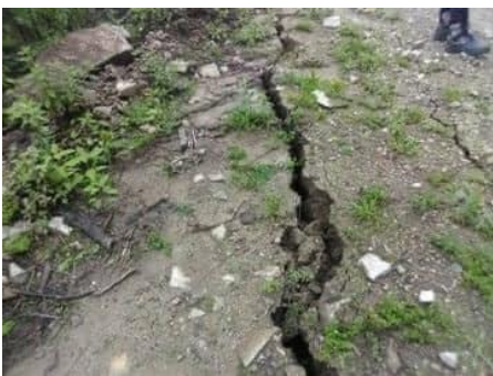
Figura 6. Grieta en terreno arenoso.
