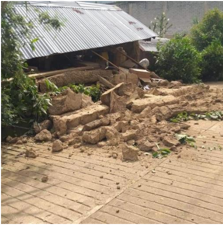
Figura 4. Caída de barda en casa de adobe. San Juan Ozolotepec, Oaxaca.
