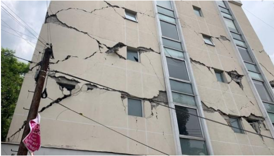
Figura 2. Edificio afectado por el sismo del 2017, afectado nuevamente por el sismo del 23 de junio, 2020; localizado entre las calles Tepic y Monterrey, en la colonia Roma, Ciudad de México. Foto, periódico La Jornada
