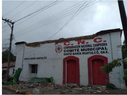
Figura 3. Inmueble afectado por el sismo del 23 de junio, 2020 en Santa María Huatulco, Oaxaca.
